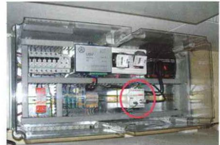
Die Funk-Fernwirkmaster werden teilweise als Relais für weiter entfernte Unterstationen verwendet.
